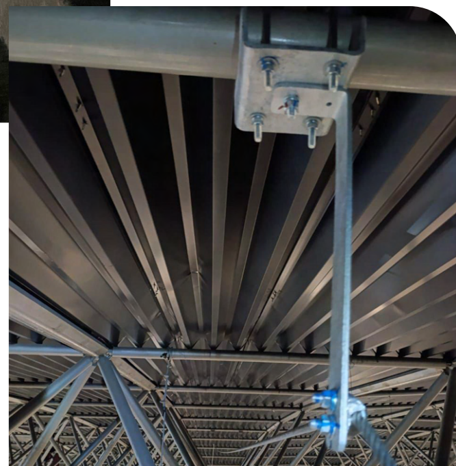
Lineas de vida en la estructura del Salón Guadalajara.
